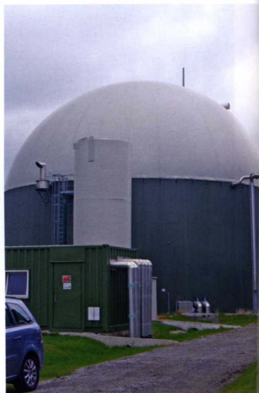
Der Gasspeicher kann bei voll ausgelasteter Anlage die Produktion von fünf bis sechs Stunden aufnehmen, darüber hinaus erzeugtes Gas müßte mit einer Fackel verbrannt werden. In dem grünen Container (links im Bild) befindet sich die Technik zur Gaswäsche.
